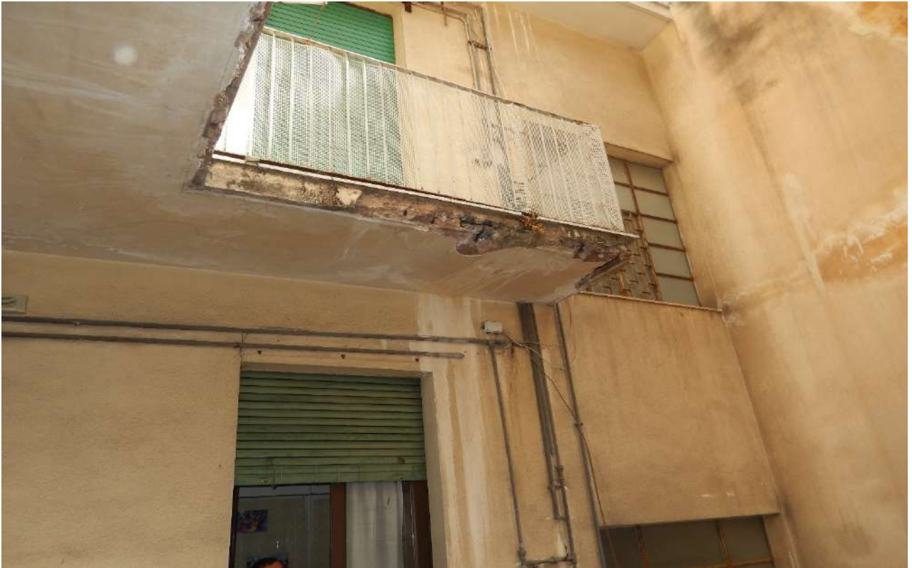
FO L1-69: particolare danneggiamenti ballatoio;
