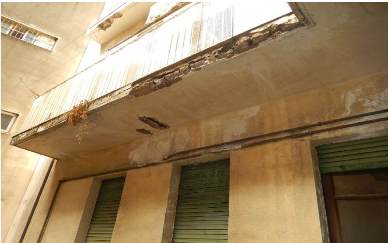
FO L1-68: particolare danneggiamenti ballatoio;
