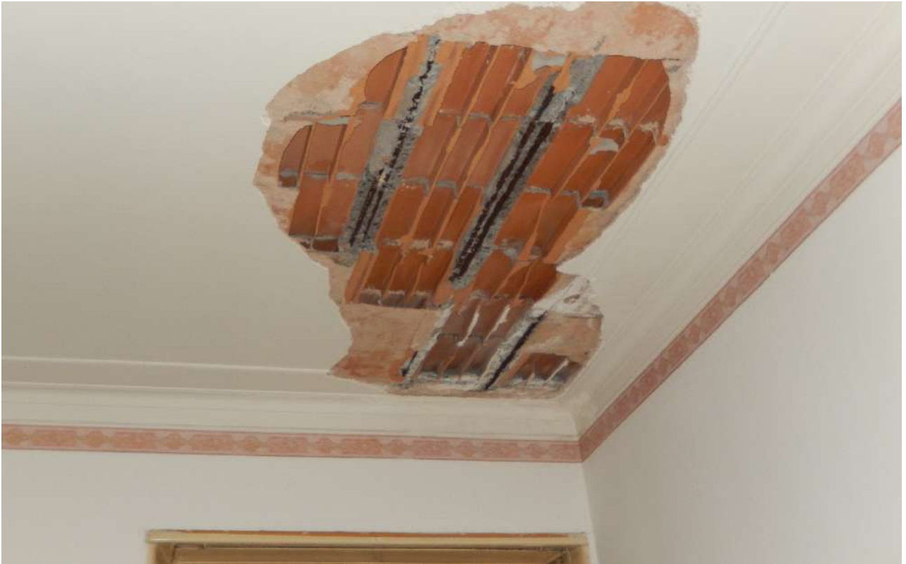
FO L1-107: particolare soffitto vano "1";
