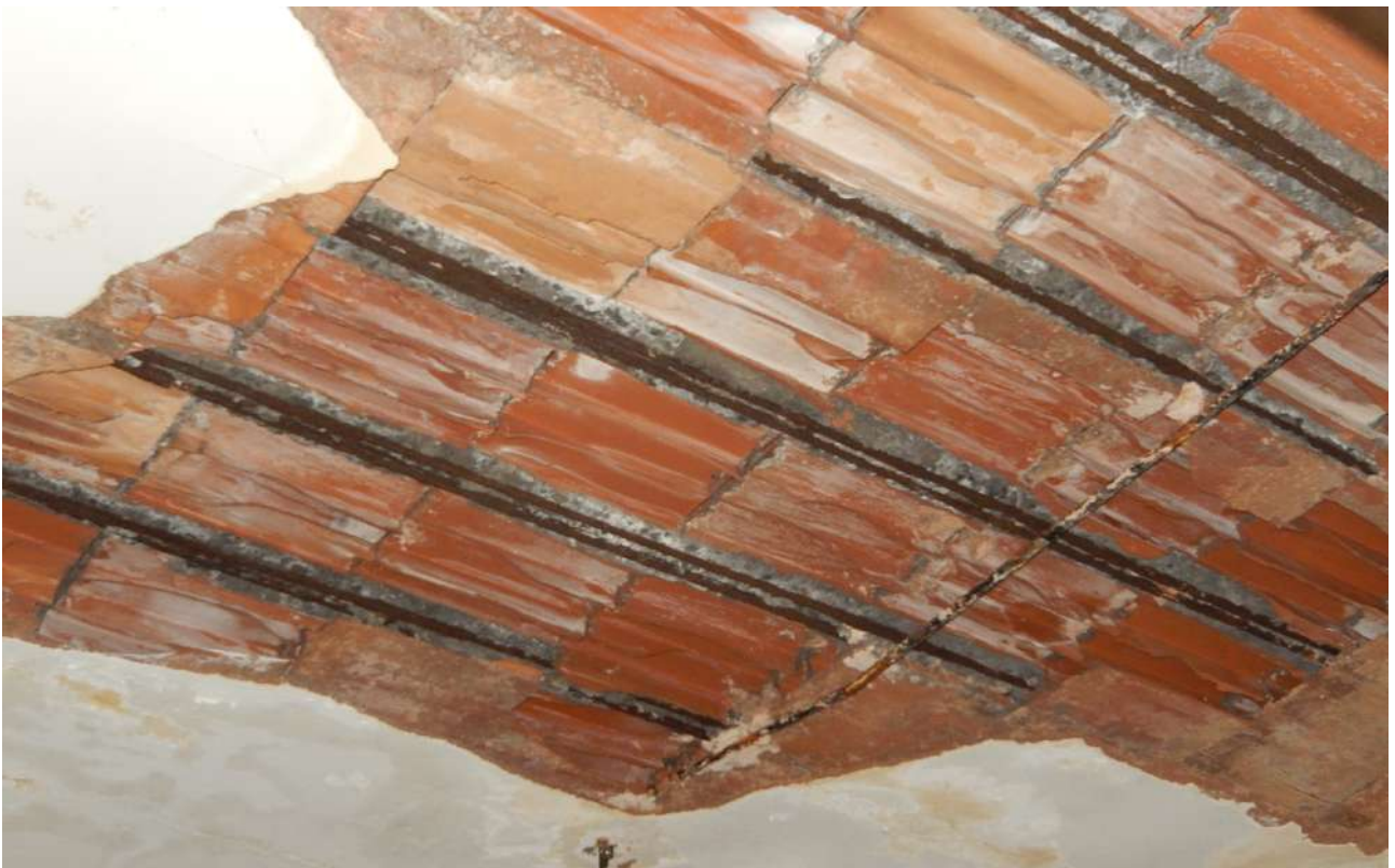
FO L1-114: particolare soffitto vano "3";
