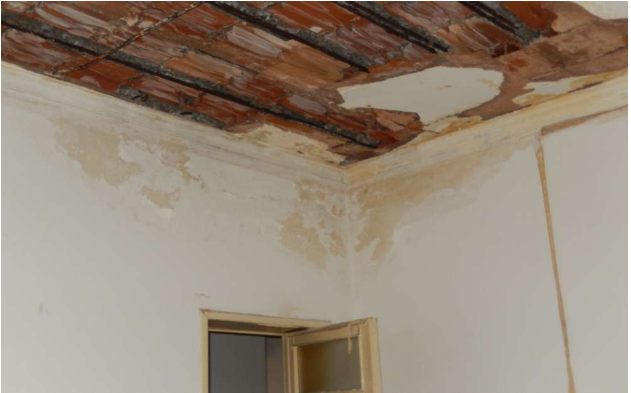
FO L1-113: particolare soffitto vano "3";
